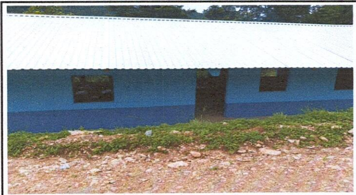
Foto1: se observa en la fotografia el cambio de techo y la pintada del edificio interior y exterior.
